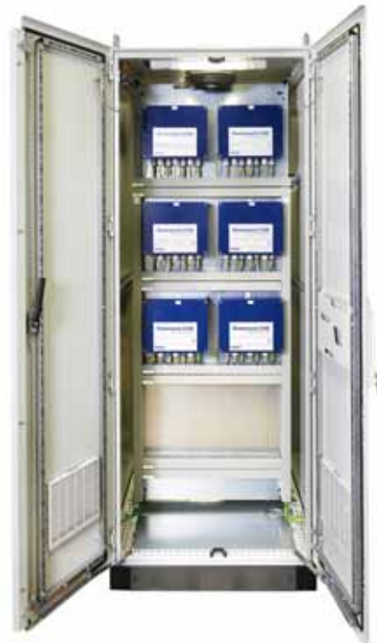
Шкаф с резервными модулями полевого соединения 2160.
